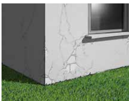
Façade en crépi fissurée
