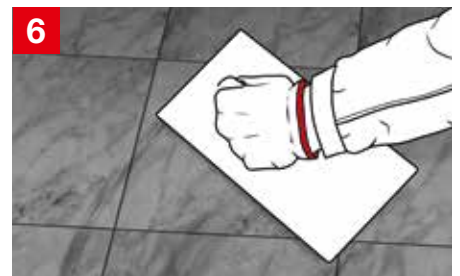
Jointoyer les dalles avec le joint pour pierre naturelle tubag TNF VarioRapid correspondant
