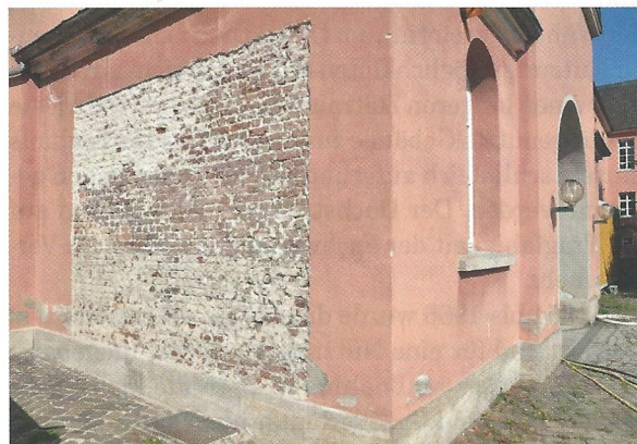
Das Mauerwerk ist intakt, an einigen Stellen kam es jedoch zu großflächigen Putzabplatzungen
